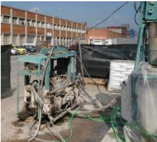
Bomba de inyección de pistón hidráulica marca Domine, con regulación de caudal, para inyección de caudales pequeños.
