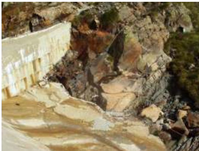
Base de la presa con grietas del macizo rocoso en las que se puede observar la salida del microcemento por las mismas.
