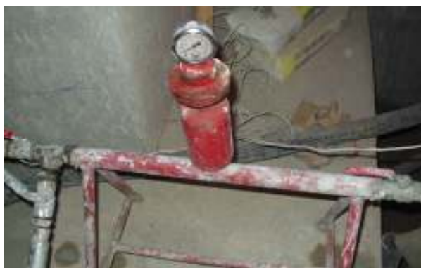
Vista manómetro indicando baja presión de inyección.
