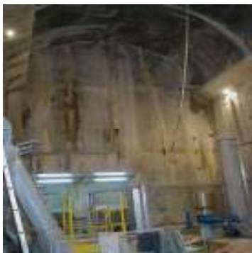
Aspecto de la cámara de válvulas después de los trabajos de inyección de microcemento Spinor A12.
