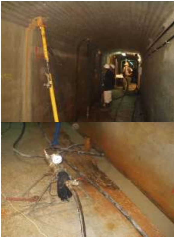
Vista inyección de drenes y detalle de manómetro para control de presión.
