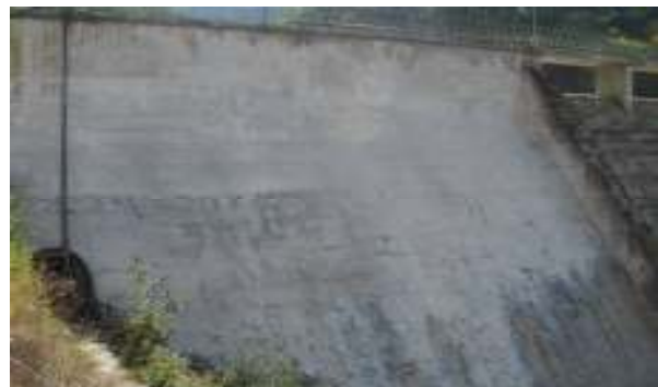
Vista de la margen derecha con afloración de lechada de microcemento tras las inyecciones.
