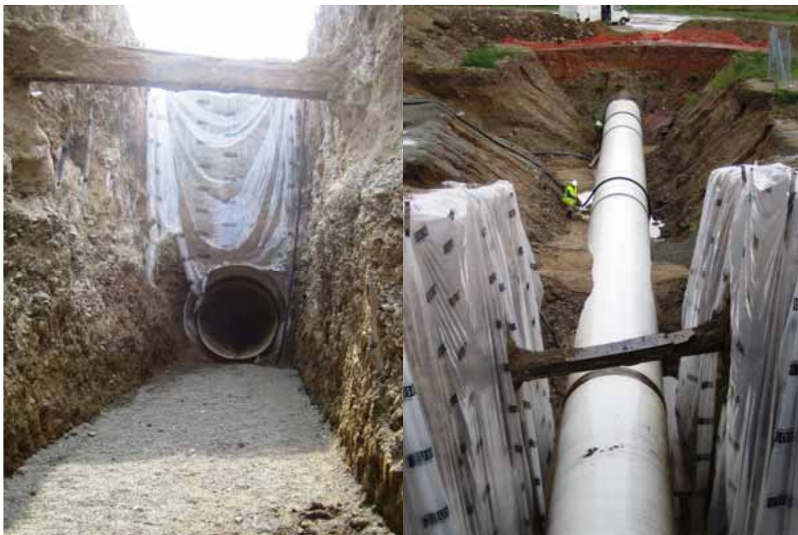
[Figura 1] Vista de la excavación y de la tubería una vez colocada.
