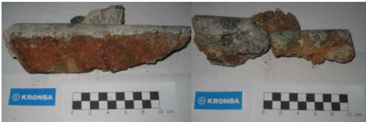
[Figura 2] Testigos recuperados en la fase previa de reconocimiento en los que se observa la degradación del hormigón de las estructuras de cimentación.
